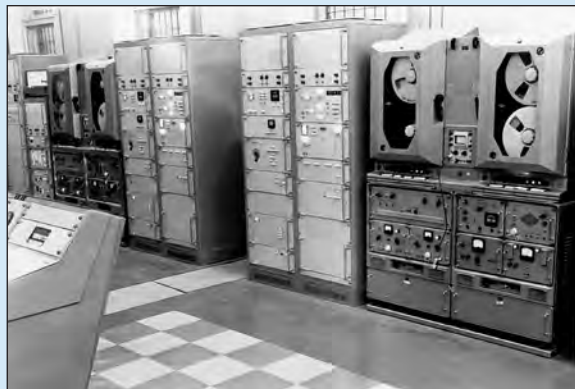
Внутренний вид станции МА-9. Видны магнитные накопители 17С06/07 (1974 г.)
